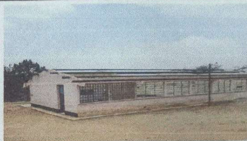
Direccion y aulas sin techo por cambio de lamina
